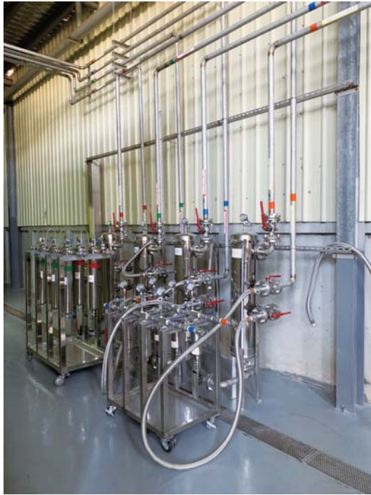
管線、過濾設備專管專用 採用PALL高規過濾設備 濾心規格0.5/0.2/0.1~0.02um
