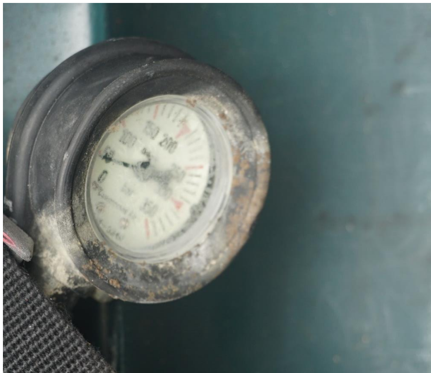
SCBA設備之錶壓狀況不良
