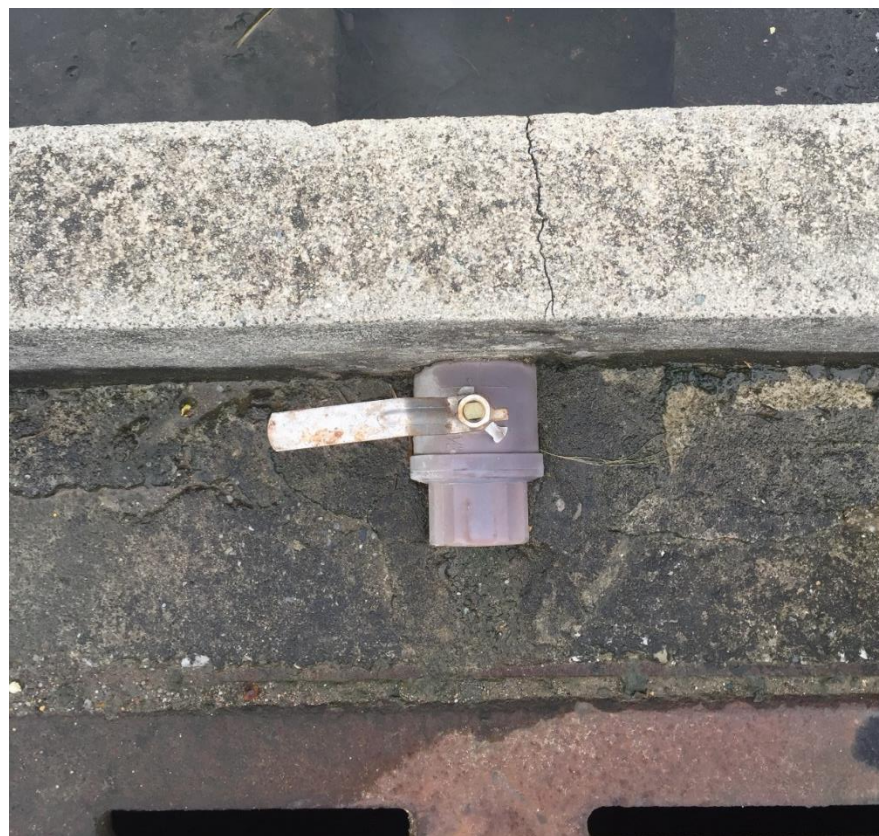
防溢堤排水孔開關閥設施
