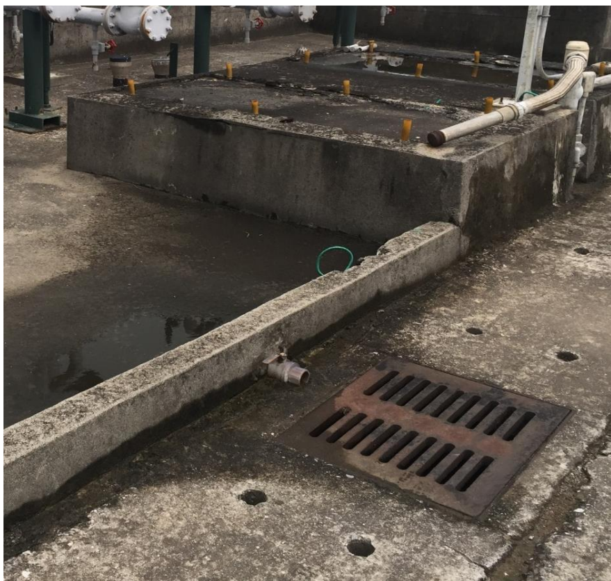
化學品儲存設施防溢堤
