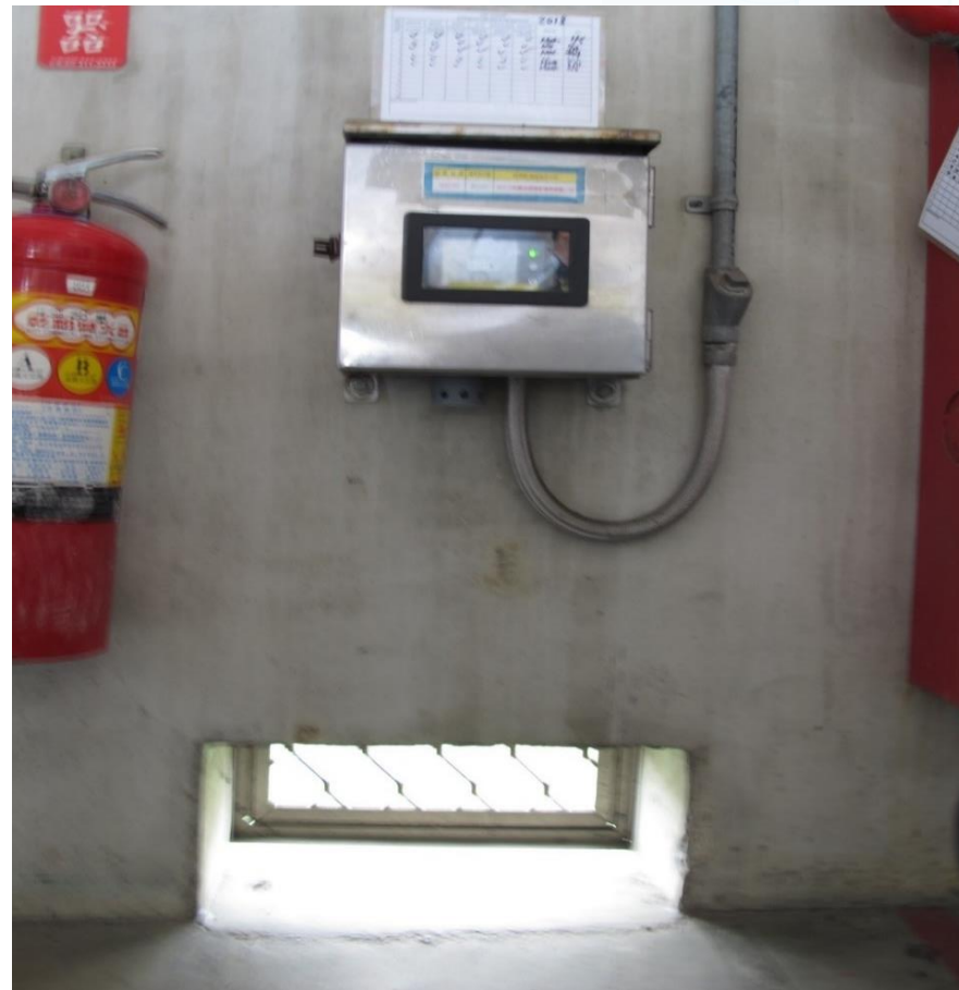
毒性氣體偵測器下方有通風口
