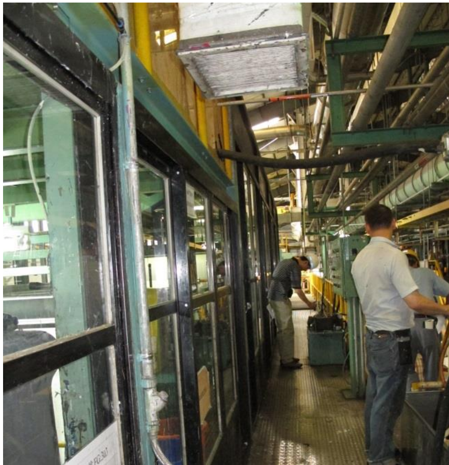
毒性氣體偵測器上方有排風管
