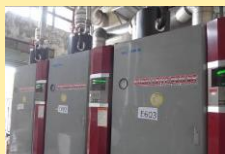
既設貫流式鍋爐
